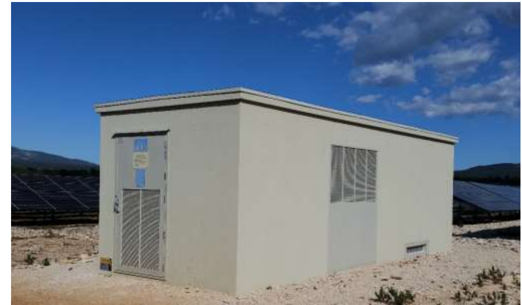
Photo 13 : Exemple de poste de transformation
