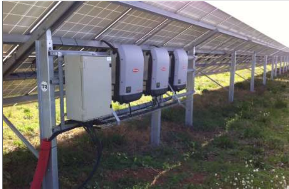
Figure 17. Exemple d'onduleurs strings fixés à l'arrière des tables de modules
