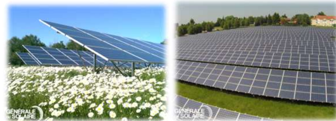
Exemple d'installation - Parc solaire de Sourdun (77)
