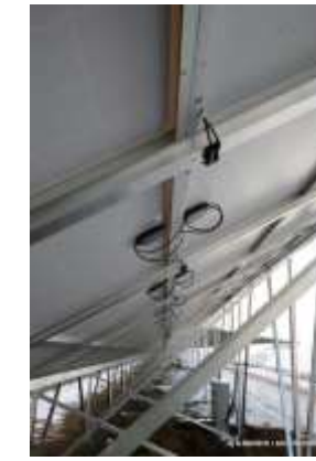
Photo 15 – Câblage sous les modules
